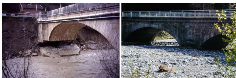
Figure 6. Deux exemples d'évolution d'un lit fluvial et ses conséquences au niveau d'un pont : à gauche l'enfoncement du lit peut conduire à déstabiliser l'ouvrage [Pont des Chaines à Die, ©F. Liebault, IRSTEA-ETNA], à droite l'exhaussement obstrue la section et peut favoriser localement des débordements. [© H.Piegay]
