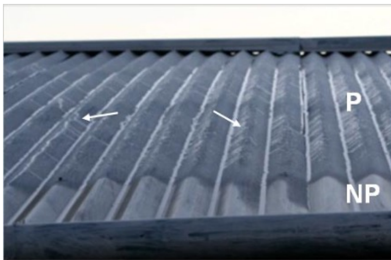
Figure 4. Gouttes glissant sur un toit en fer galvanisé ondulé à Combarbala (Chili) avec un petit angle d'inclinaison ( \approx 15^\circ ). P : Partie peinte avec des additifs (OPUR [12] ) où la rosée se forme et les gouttes glissent sur les ondulations (flèches). NP : Partie non peinte où la rosée ne se forme pas. [Source : J.-G. Minonzio].
